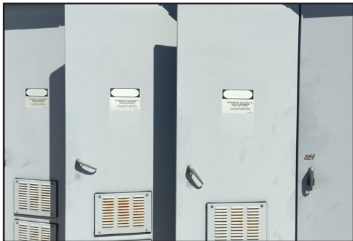
Main 4.16kV Switchgear
