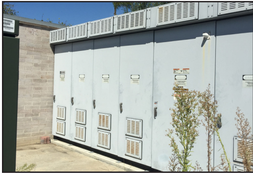
Main 4.16kV Switchgear
